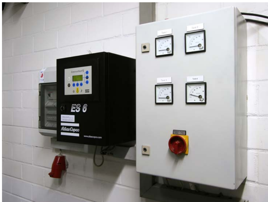
Die in den GA-Kompressor eingebaute Elektronikon-Steuerung (oben) ist in das Energiesparsystem ES 6 von Atlas Copco (an der Wand) eingebunden. Dieses schaltet im Notfall automatisch auch die noch vorhandenen älteren Verdichter hinzu. (Bild: Atlas Copco Kompressoren und Drucklufttechnik GmbH)
